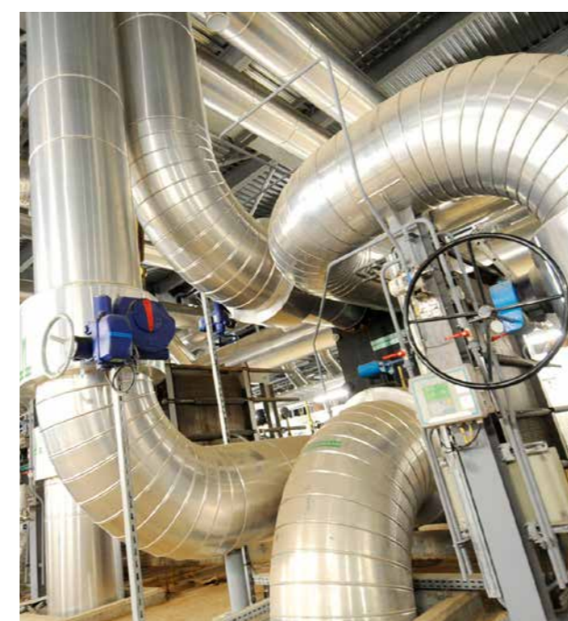
Alençon collecteurs réseau de froid
